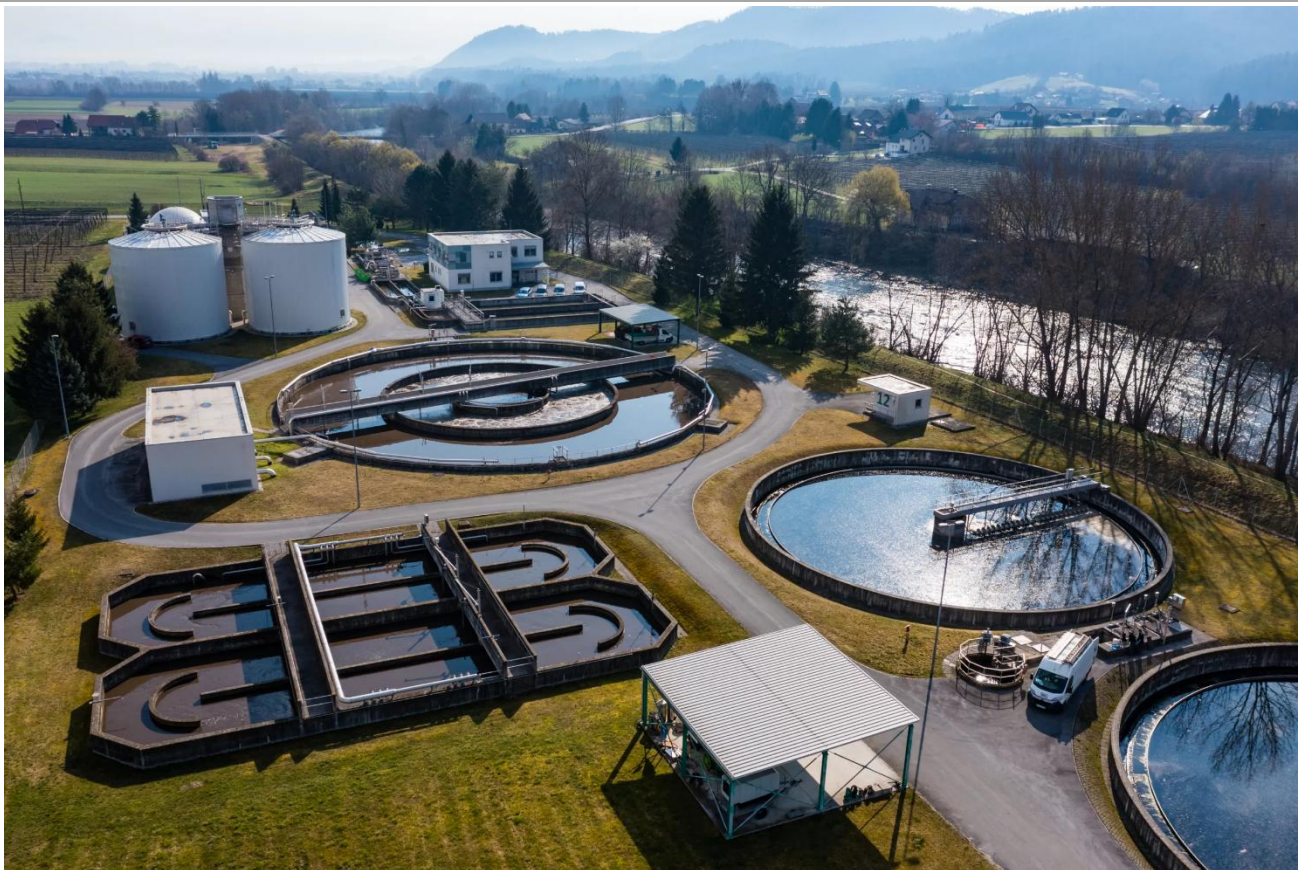
Slika 12: Centralna čistilna naprava Kasaze 42
