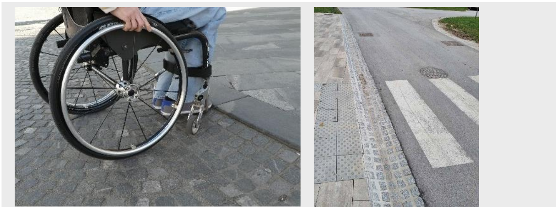
Sliki 4 (neustrezno): Ovire za uporabnike invalidskih vozičkov na pločnikih. Pri načrtovanju je treba določiti glavne smeri gibanja pešcev. 1: Poglabljena mulda in robnik ovirata prehod z invalidskim vozičkom. Če je predvideno, da se pešci gibljejo vzdolž robnika (npr. v območjih za pešce), je lahko takšen robnik ustrezen ukrep za olajšanje orientacije slepih in slabovidnih, vendar morajo biti ustrezno urejena mesta prehoda z nižanim robnikom. 2: Kjer je predvideno prečno gibanje pešcev čez muldo, takšna postavitev predstavlja oviro za prehod uporabnikov invalidskih vozičkov in je neustrezna.
