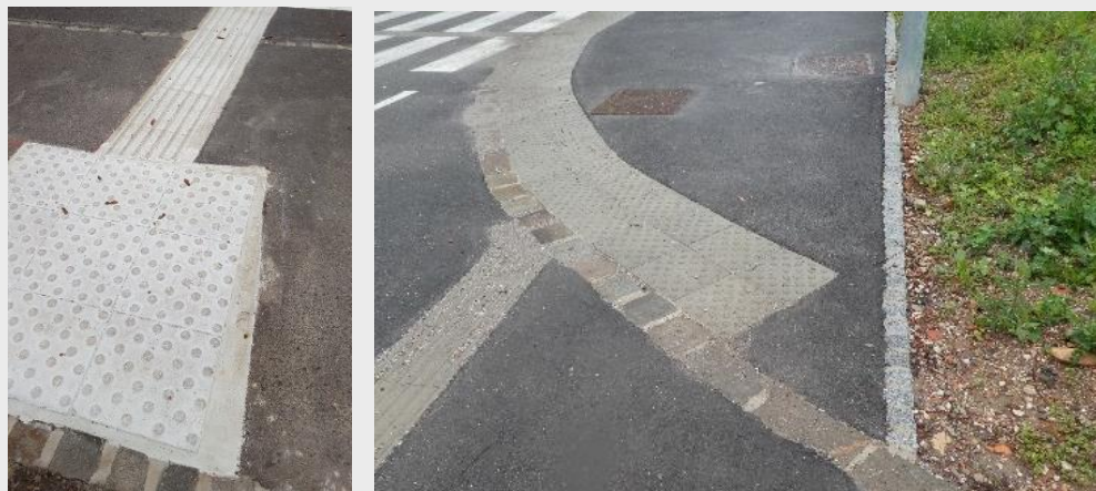
Sliki 15 (neustrezno): Primera nenatančne izvedbe taktilnih oznak. 1: Izvedba z načinom naknadne vgradnje. Izrez za taktilne oznake je bil prevelik glede na predvidena polja. Vsaka dodatna zapolnitev z različnimi materiali pomeni več neravnin v tleh, kar je neustrezno tako za tipno zaznavnost kot tudi za prevoznost s pripomočki na kolesih. 2 Izvedba z načinom predhodne vgradnje, pri kateri je bila struktura ob asfaltiranju zelo poškodovana, taktilne oznake pa niso bile izvedene do roba. Če hodi uporabnik bele palice ob robu zelenice, je zelo verjetno, da čepastih oznak ne bo zaznal – opozorilni čepasti pas tako ne bo opravil svoje funkcije.
